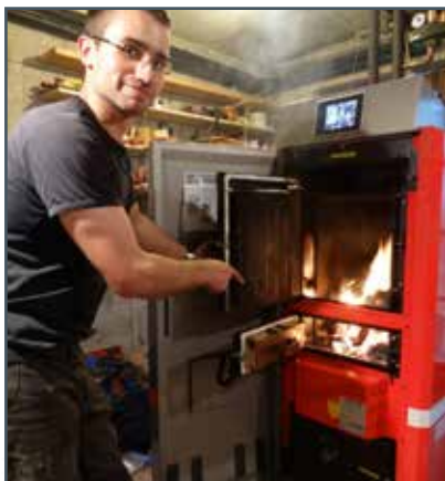
La chaudière préparée pour son démarrage automatique, dès qu'elle en aura la consigne.
