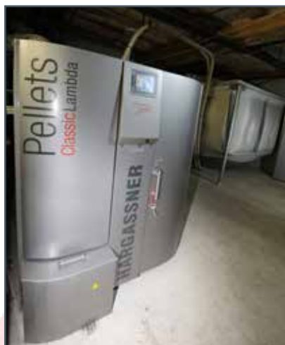
Chaudière à granulés et sa trémie cyclonique
