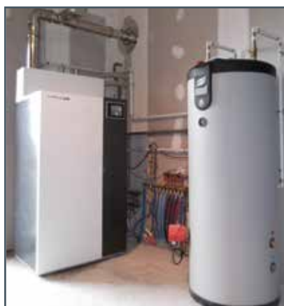
Petite chaufferie de 3 m 2 seulement !
