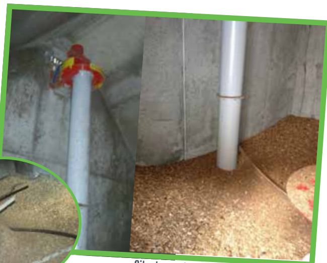
Silo de stockage avec vis verticale de 5 m
