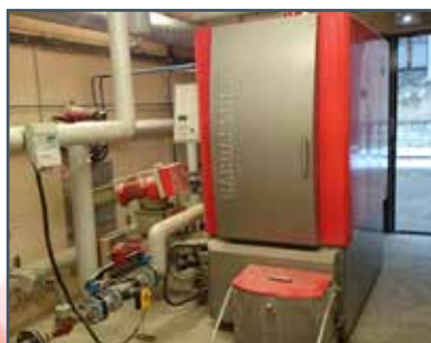
Chaufferie indépendante de la Mairie
