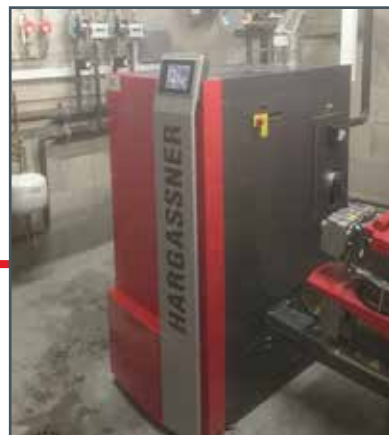
Chaufferie de la salle des fêtes
