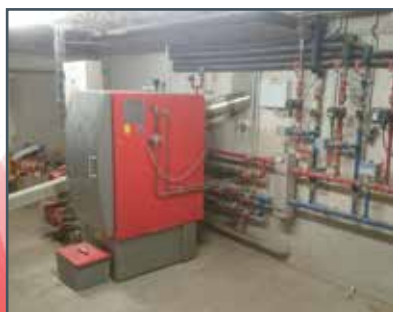
Chaufferie en sous-sol de l'Ecole
